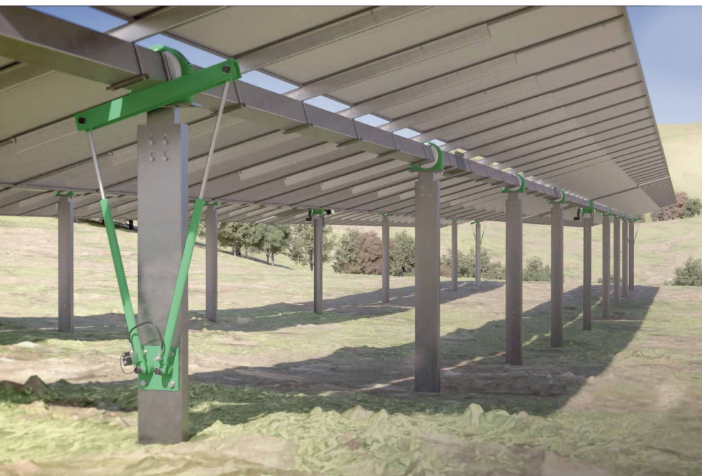
Photo: ESA Solar
